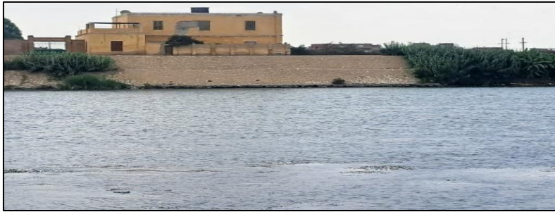
صورة (١٣) مبنى يعلو الضفة وحدث تقويض سُفلي عند حضيض التكسية
