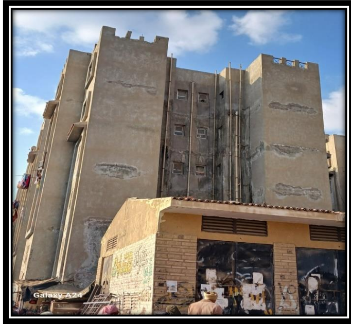
صورة (٢٢) توضح شروخ المباني بمنطقة الدراسة بتاريخ ٢٠/٨/٢٠٢٤.
