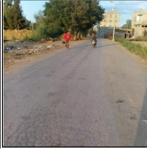
الدراسة الميدانية ٢٠٢٠/٤/١٤ صورة (١١) كثرة الشروخ والتشققات العرضية على الطرق المرصوفة بالمركز ، طريق الزرقا - منية النصر
