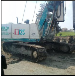
الدراسة الميدانية ٢٠١٩/٧/٢٥ صورة (١٢) تعطيل الحركة المرورية بسبب عمليات الحفر بالطرق ، طريق ٤٣ الرئيسي
